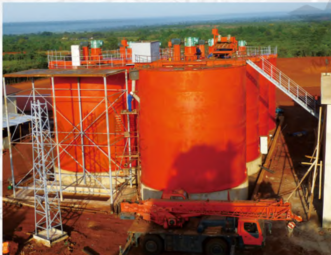
坦桑尼亚 1200 吨 / 日金矿选厂项目
